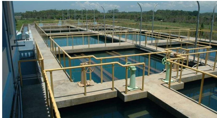
Tanques de tratamento de água
